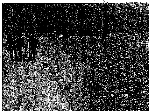
⑫ [No.44] STA.14+885-14+925 : 流水による護岸洗堀 (DORにより仮復旧済)
