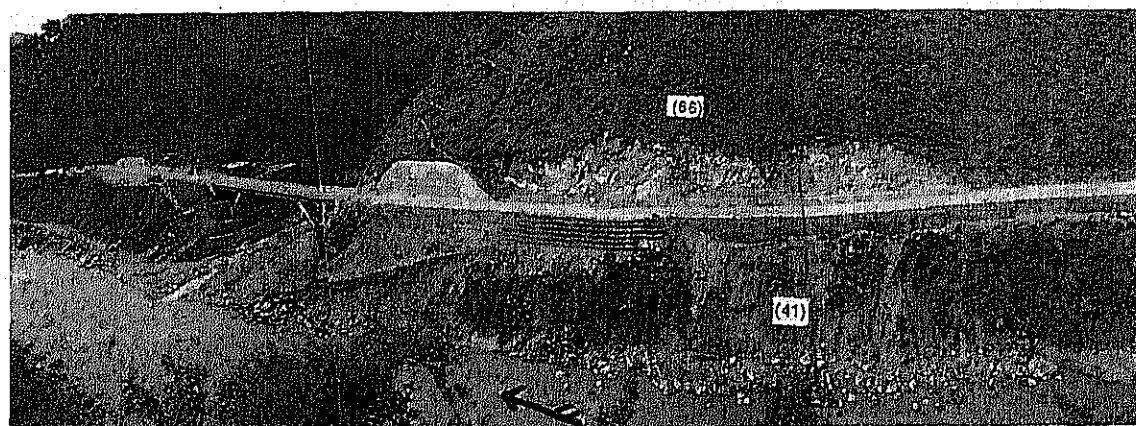
⑪ [No.41] STA.13+262 : 流水による斜面崩壊
