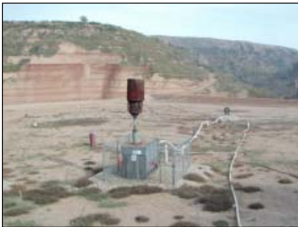
メタンガス回収システム実験施設
