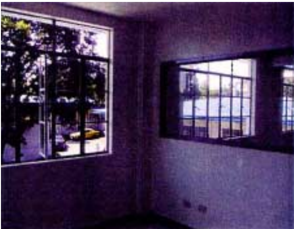
新規建物:窓の補強・改修が必要
