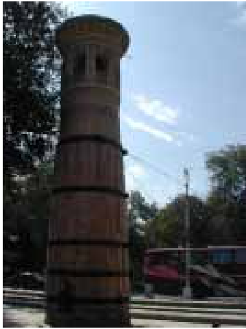
ブハラ遺跡 崩壊防止用にワイヤーで固定 撮影日:平成14年9月13日
