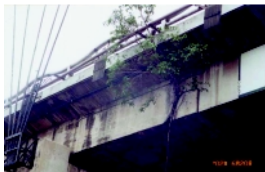
PC桁ゲルバー部のクラック(樹木植生)
