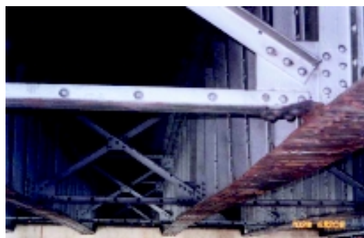
鋼桁下フランジの腐食
