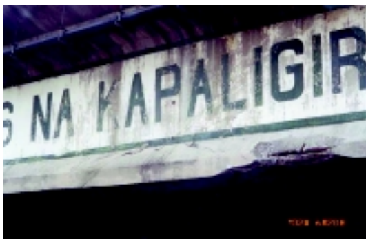
損傷部の鉄筋・PCシース管の露出
