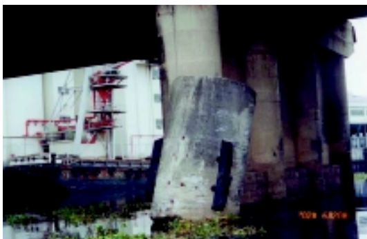
船舶衝突による橋脚防弦材の転倒
