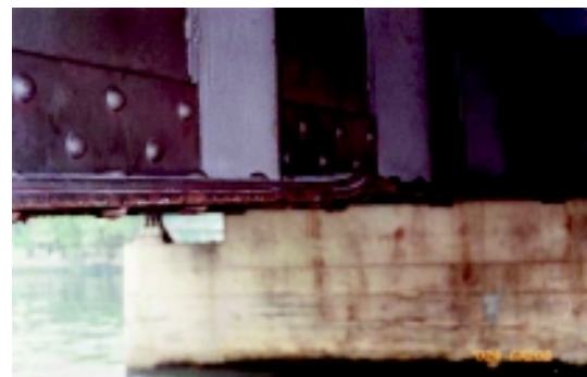
鋼桁への船舶衝突による下フランジの変形
