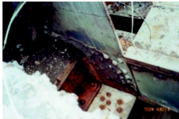
トラス下弦材の格点腐食 (特にリベットの腐食が激しい)
