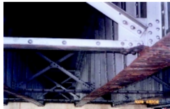
鋼桁下フランジの腐食
