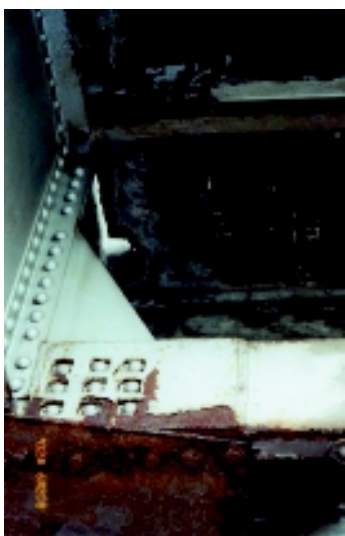
床版からの漏水による部材の腐食
