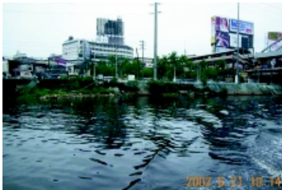
グアダルーペ橋付近の河岸浸食 これより上流側にいたるところみられた
