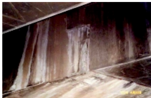
PC桁ゲルバー部からの遊離石灰
