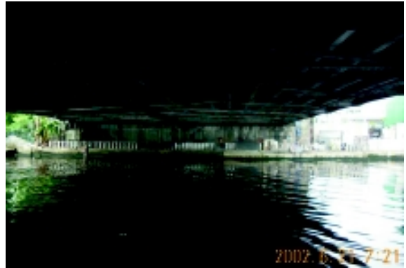
アヤラ橋 橋台全面のスクウォッター
