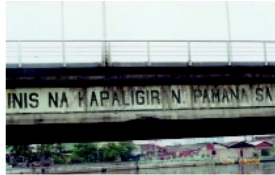
船舶衝突による下フランジの損傷
