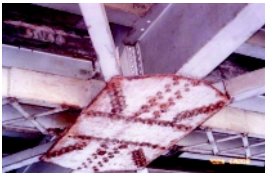
トラス格点ガセットの腐食 (リベット腐食が激しい)
