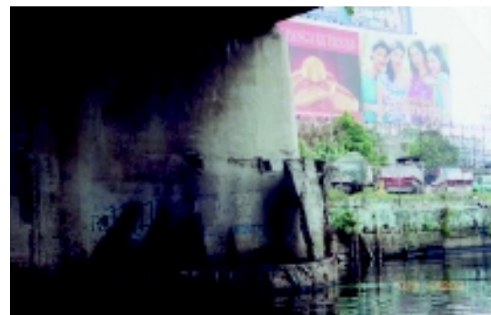
船舶衝突による橋脚防弦材の破損
