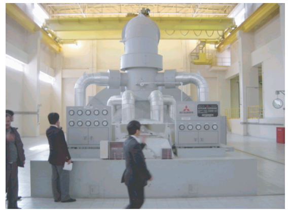
ジャンダール発電所構内
