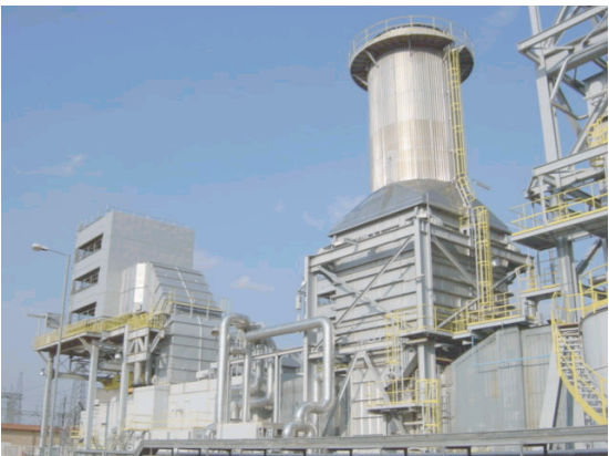
ジャンダール発電所ガスタービン
