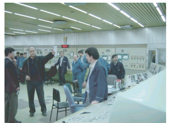
セイトメル発電所中央制御室
