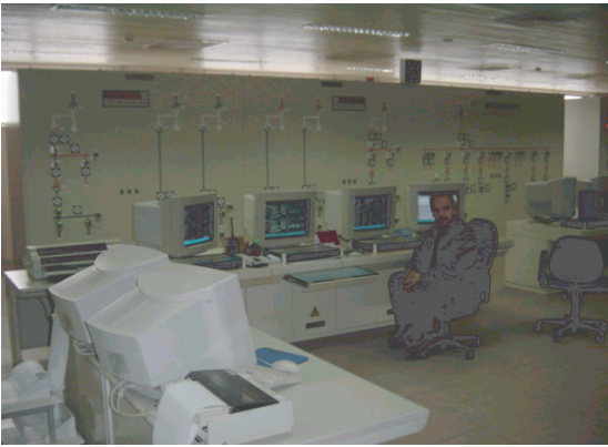
ブルサ発電所中央制御室
