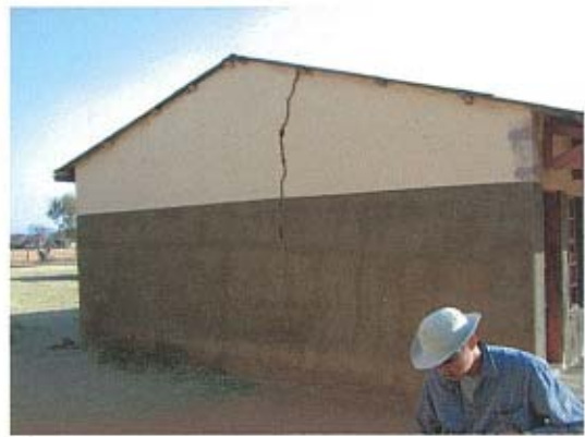
壁面のクラック
