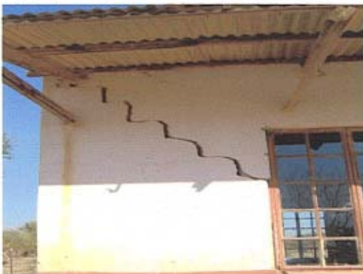
壁面の大きなクラック
