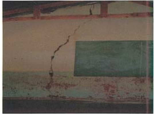
壁面の大きなクラック
