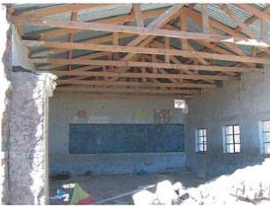
妻側壁が完全に崩壊している。
