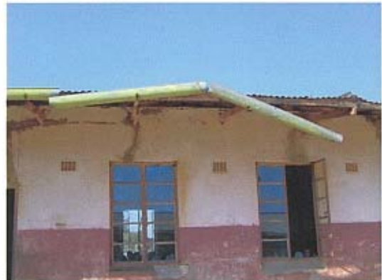
窓上部における構造クラック
