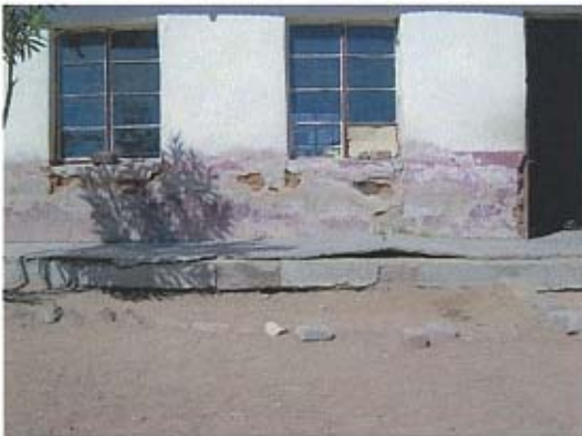
地盤沈下による床のひび割れ、剥離。
