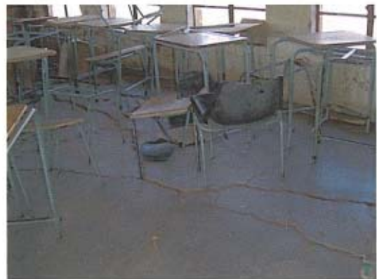
土間スラブの構造クラック
