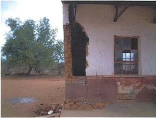
妻側壁が崩壊している。
