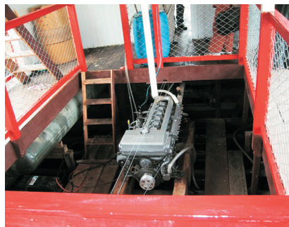
■ Sala de Motor
