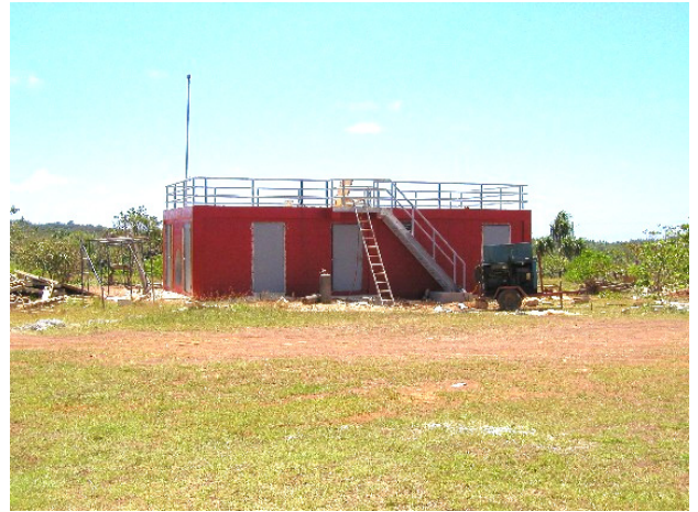
消火訓練用に建築されている施設 外装・内装共にほぼ完成している
