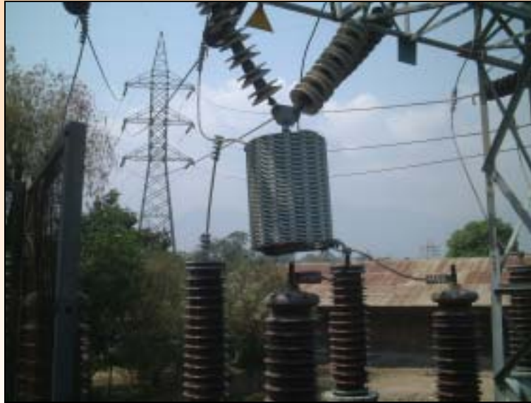
Teku 変電所より Siuchatar 変電所へ伸びる 66kV 送電線
