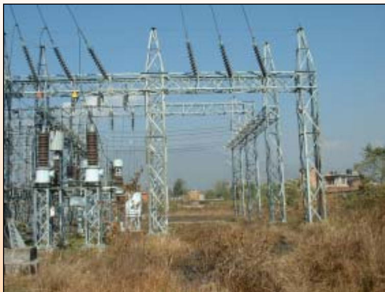
既設 66kV ベイ東側
