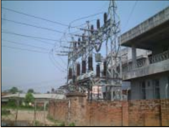
Siuchatar 変電所へ向う 66kV 送電線
