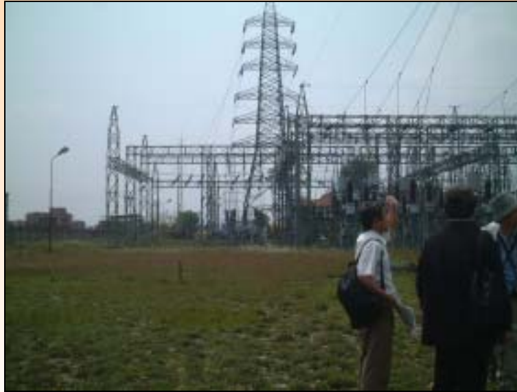
既設 66kV ベイ西側
