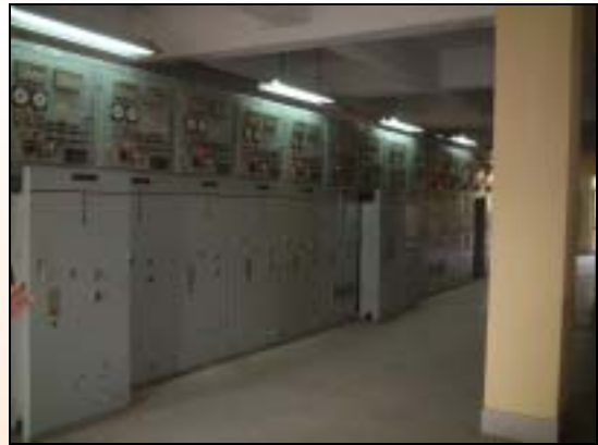
11kV キュービクル
