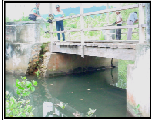
地震により破損した橋台
