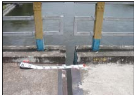
第一スパンと第二スパンの離間状況
