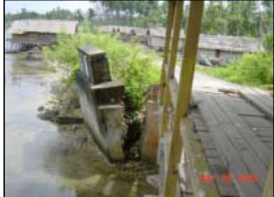
地震により破損した橋台
