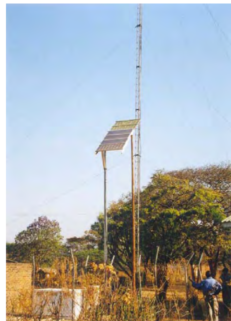
Photo 8-12 電話局に設置されている SHS (Mbalachanda TC in Mzimba District)
