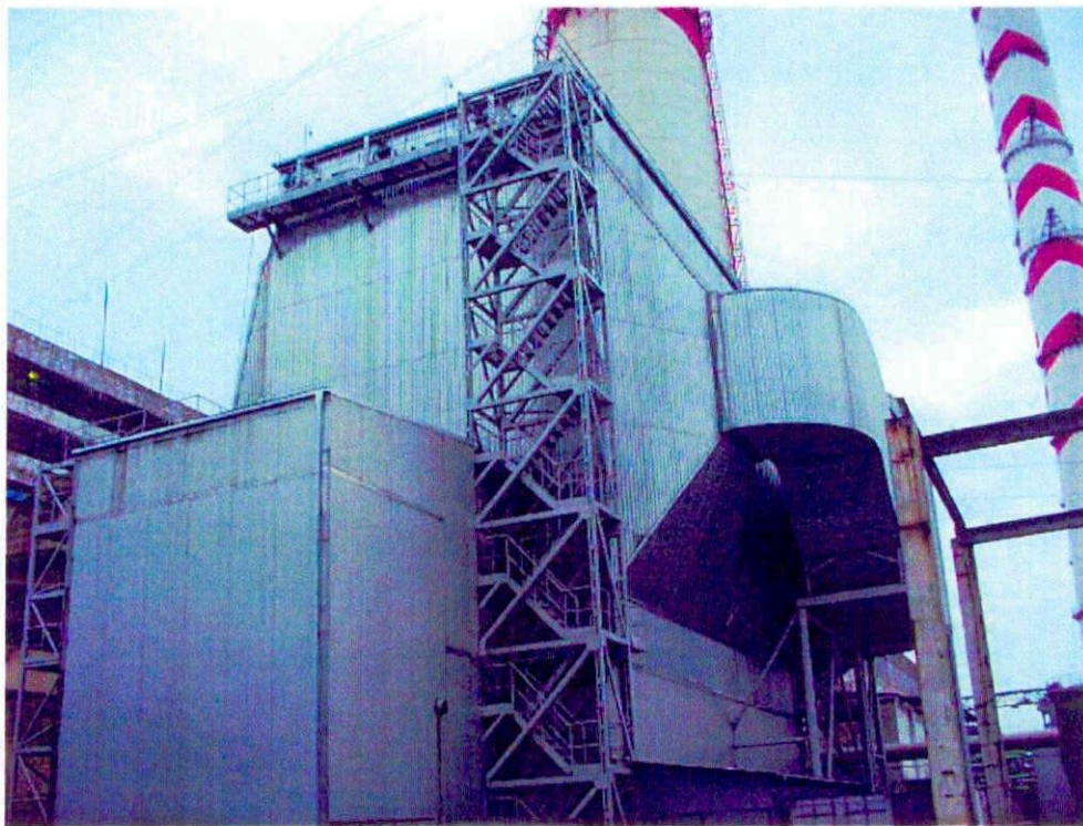
発電所内排出ガス電磁集塵装置（外観）
