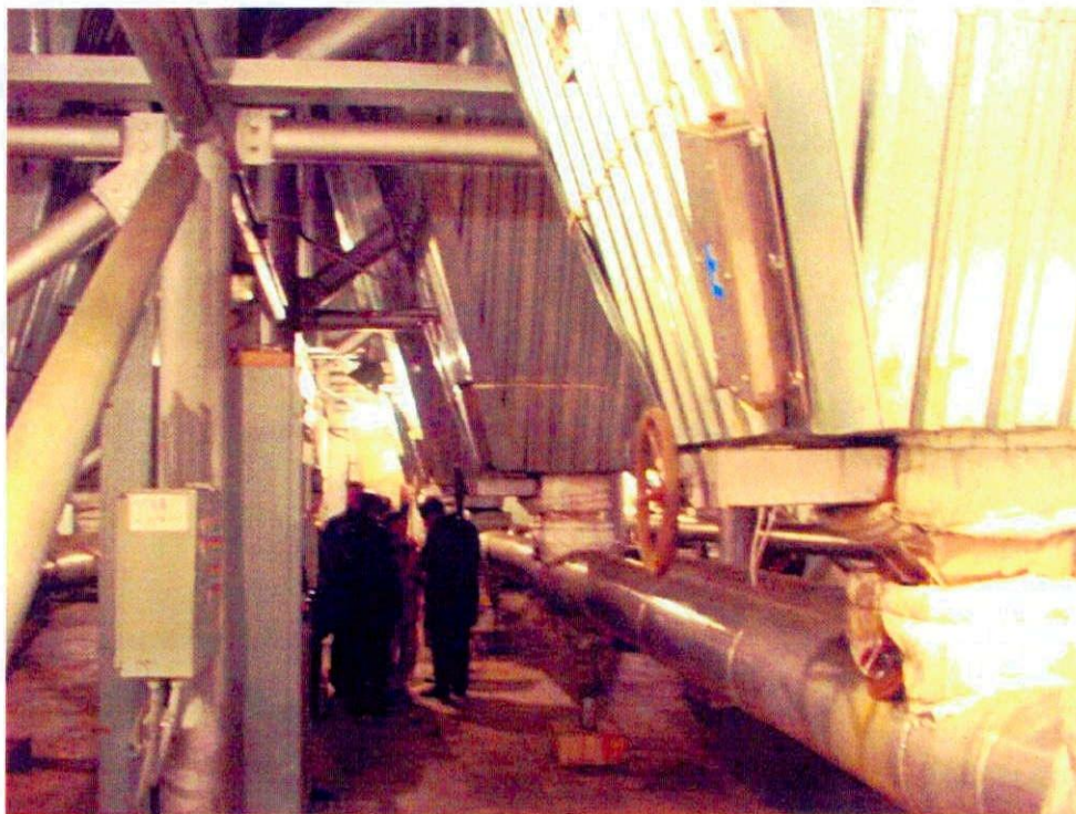
発電所内排出ガス電磁集塵装置（内部）
