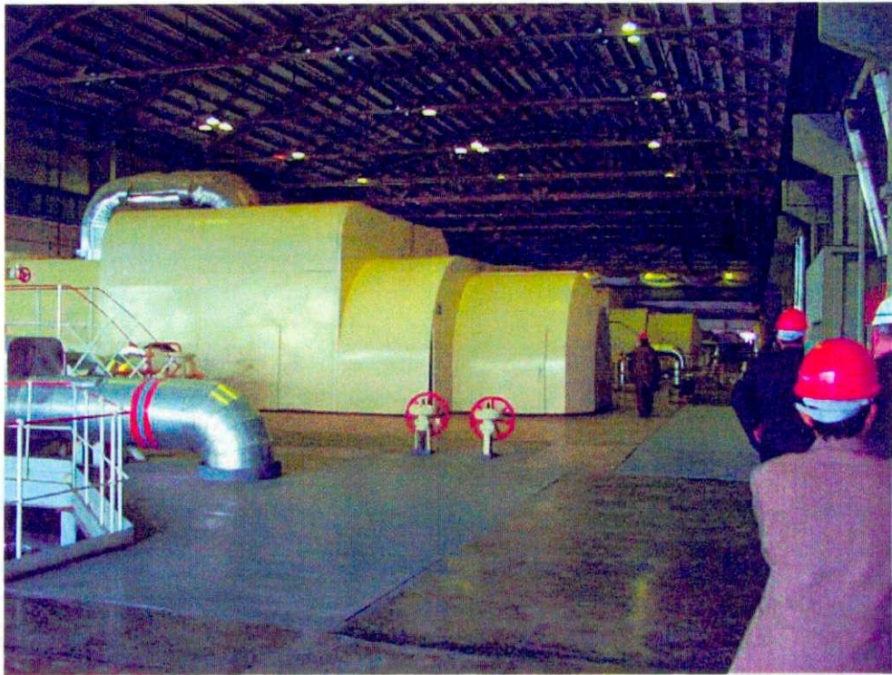
発電所内蒸気タービン（建屋内に設置）
