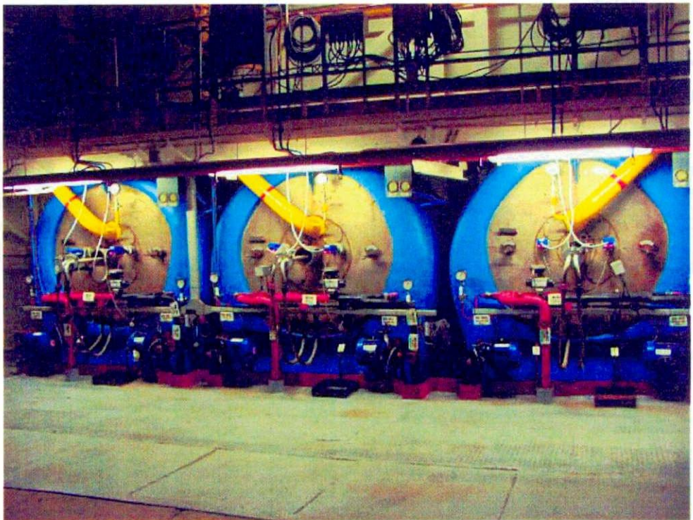
発電所内ボイラーの二段燃焼バーナー
