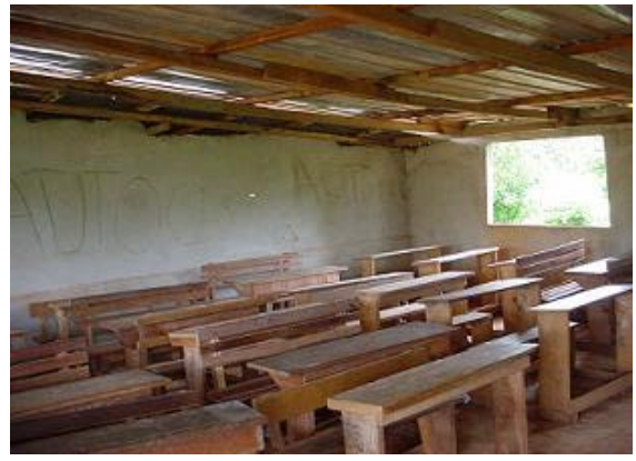
AB-05 Assangbaji-3小学校 屋根には穴があき、窓もないため雨の時は授業も十分に行えない。
