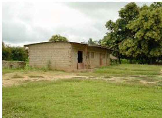
BK15 Petenou小学校 住民が建設した校舎。老朽化しており劣悪な教育環境である。
