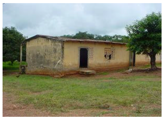
YM-6 Assie-Assaso小学校 老朽化した校舎。窓の穴あきブロックも崩れ落ちている。
