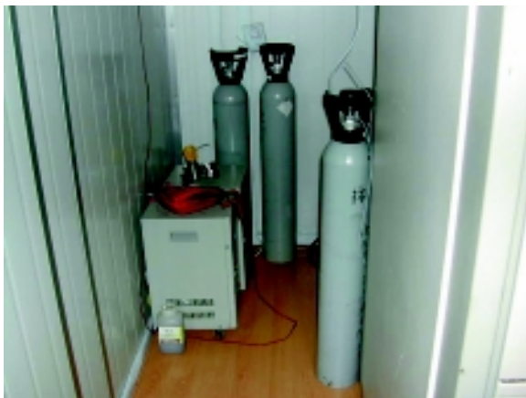
局舎内の標準ガスボンベ
