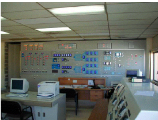
ザイ浄水場操作盤
