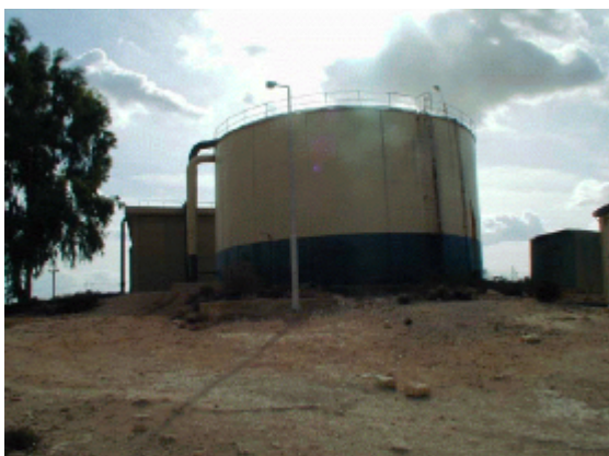
ハウポンプ場水槽
