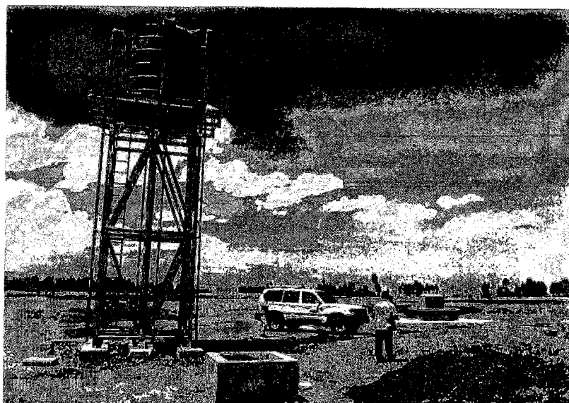
■モデル地区活動で建設した水供給施設（トゥメ給水点：貯水タンク及び共同水栓）
