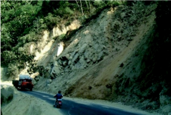
地すべりにより1車線に狭まっている
