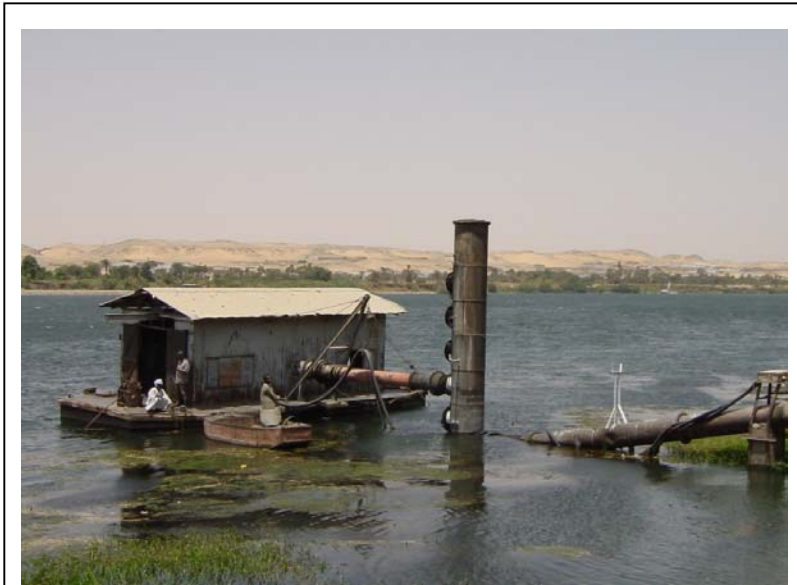
No.22 Sahel Alakaba Kebli フローティングポンプ場、 送水タワー、接続パイプ、 および送水パイプ：ポンプ 操作員はポンプ場に小船で 移動している。
