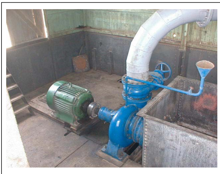
No.23 Al Rakikin Sahel フローティングポンプ場の内部：ポンプとモーター、吐出管は塗装されている。手前の鋼製箱は吸水槽である。
