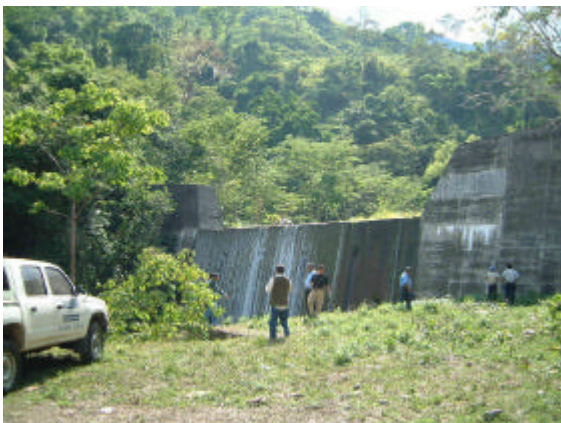
本事業による砂防ダム
