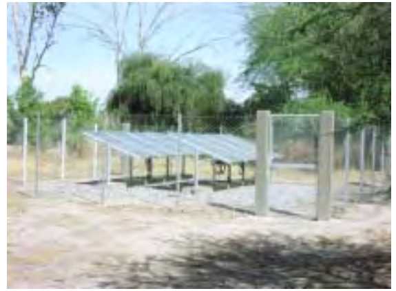
建設された太陽光発電設備
