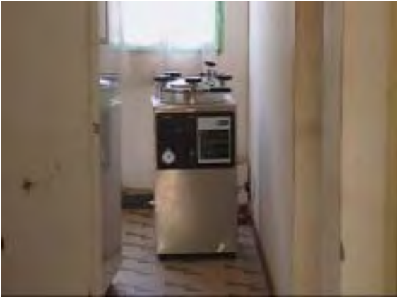
保存室の既存機材（オートクレーブ）
