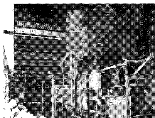
廃棄物焼却炉
