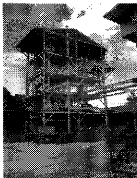
廃溶剤分留装置
