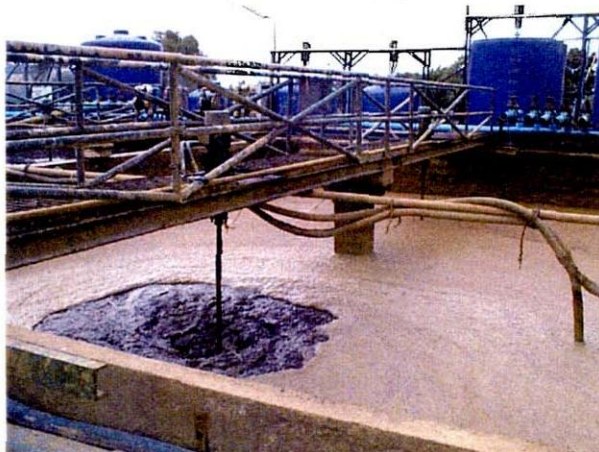
廃棄物処理工場: Genco Samaedumプラント (3: 染色廃水処理)
