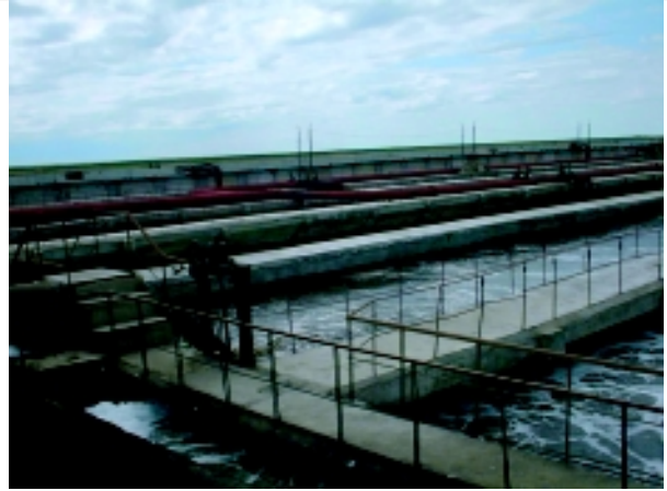
エアレーションタンク (コンクリート躯体は老朽化)
