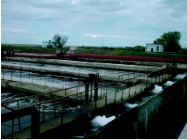
エアレーションタンク (洗剤の泡が発生している)
