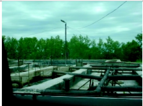
沈砂池（管は排泥管）パイプ、 コンクリート躯体とも老朽化が激しい。
