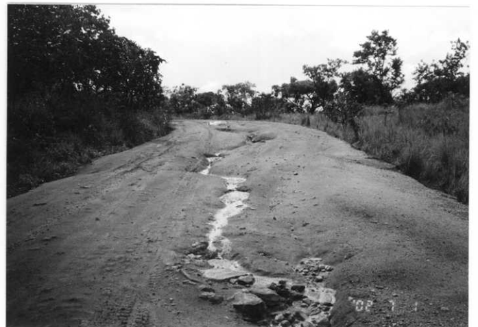
写真 No.18 侵食された路面多く、低速度走行のみ可能 （表 3-5 中レベル 1）
