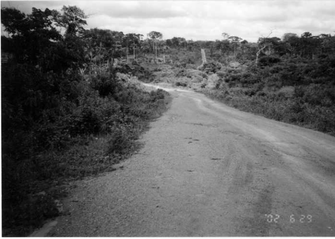
写真 No.19 不良なラテライト路面 (表 3-5 中レベル 2)
