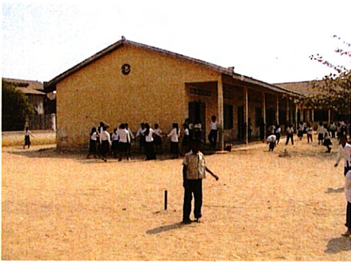
建設予定サイト (2) (解体予定の既存校舎。老朽化が著しい。)
