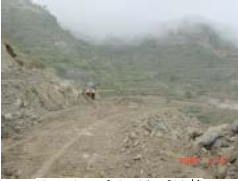
IB-14 Iryan School for Girls校 幹線道路から20km、道路工事中。
