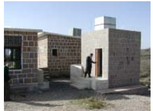
KfW: 便所、水洗だが給水が無い。
