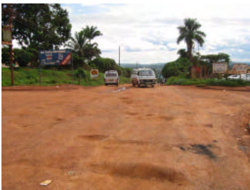
2km 地点の路面状況
