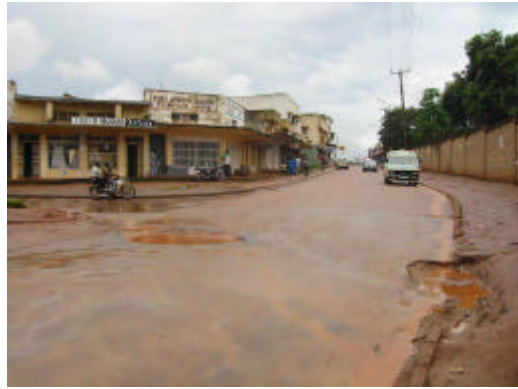
ポットホール及び路肩の損壊 (1km 地点)
