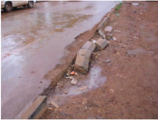
縁石損壊箇所 (Bakuli 交差点付近)
