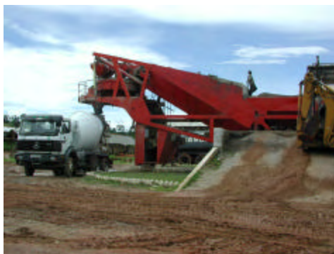
コンクリートプラント カンパラ市北 7km のセメントス社
