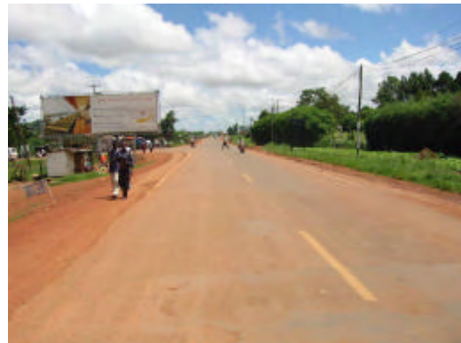
オーバーレイ終点部 8km 地点の路面状況
