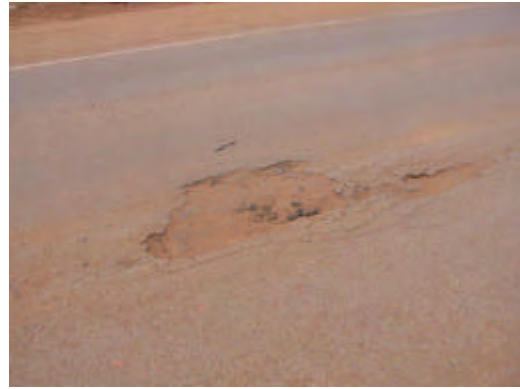
一部既に舗装表面にクラック及び剥離箇所が存在(2.3km地点)
