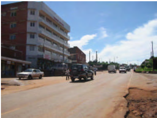
路肩舗装の破損する箇所も存在(4.4km地点)
