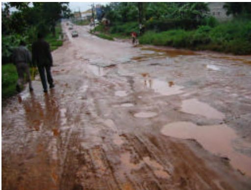
1.6km 地点の路面状況
