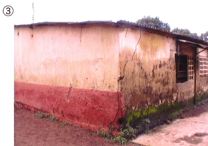
M10 Hadja Aïcha Bah 壁面に大きな亀裂がはしり、危険な状況にある教室棟。この校舎は、本計画建替え対象である。
