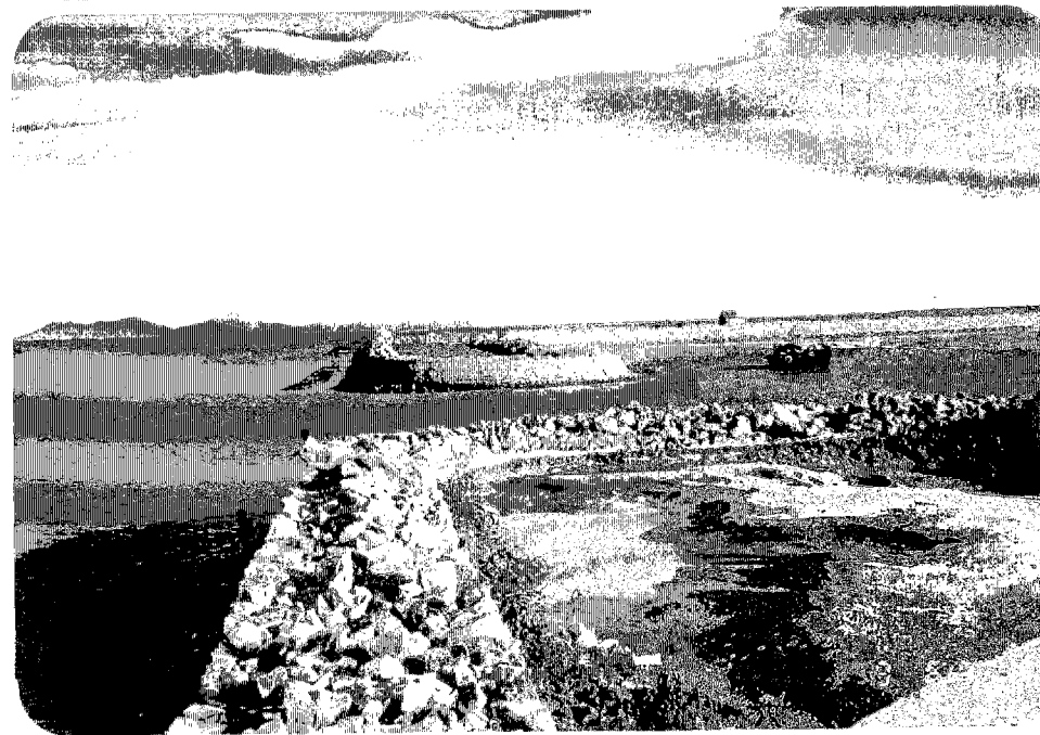
2 珠江口蕉門河口付近。 石積み護岸の内側には浚渫した土砂を入れる。
