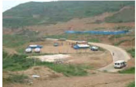
埋立機材・タンク車の車両基地
