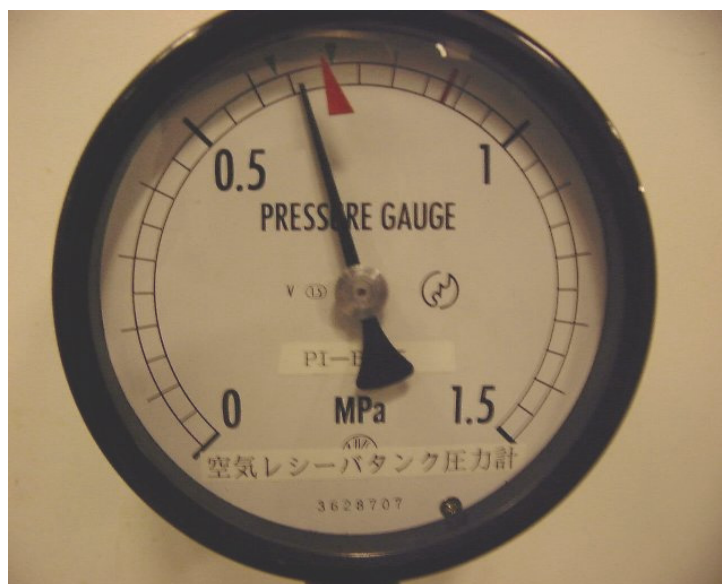
Fig. 6.2-2 現場指示計のマーキング
