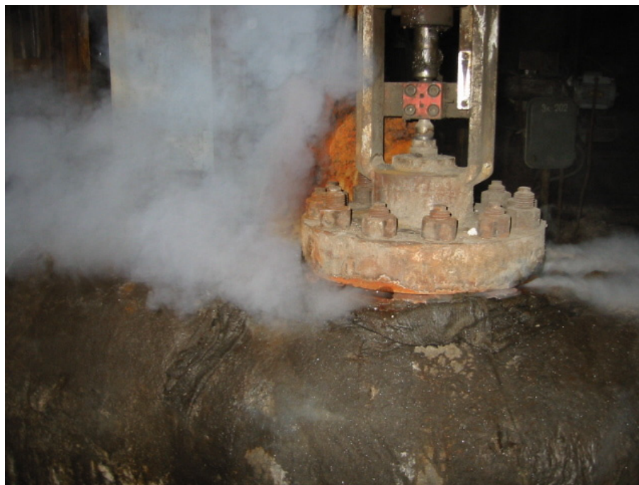
Fig. 5.2-9 給水バルブのリーク状況
