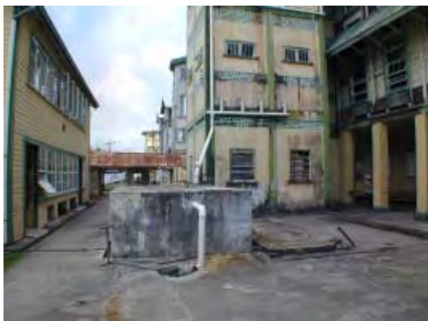
浄化槽 (浄化槽で処理した汚水は直接側溝に放流されている。)
