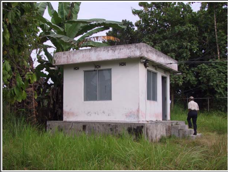
コメリン川自動側水所 (水位計故障放置)
