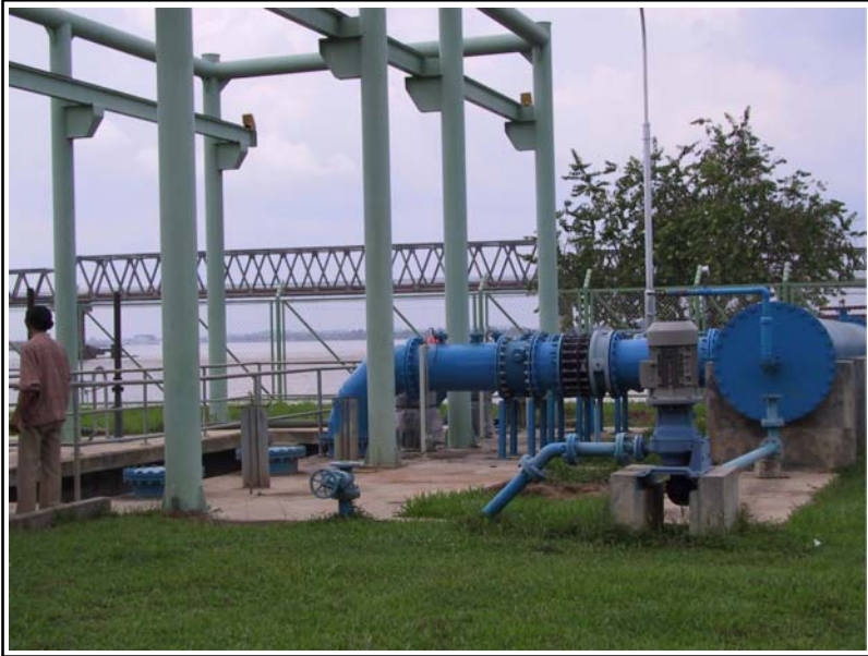
パレンバン市上水道取水設備
