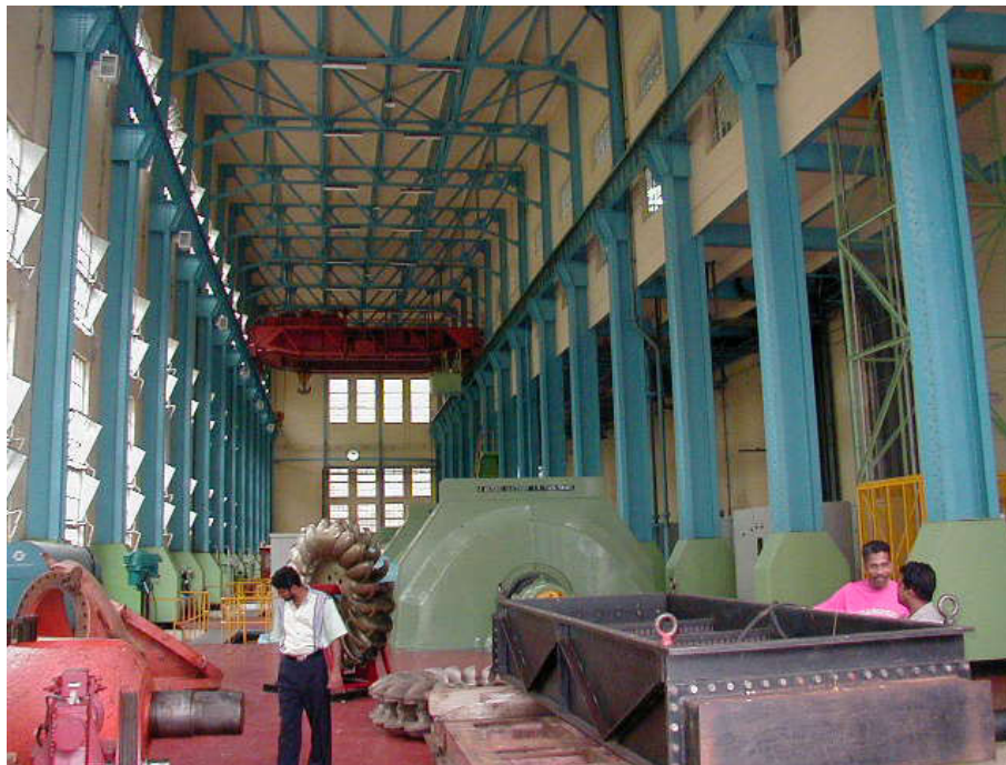
Samanela発電所の内部
