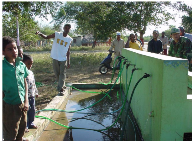
公共水栓と給水パイプ (モンテ・クリスティ県)
