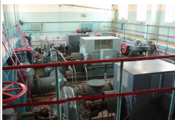
無償資金協力で改修された送水ポンプ施設
