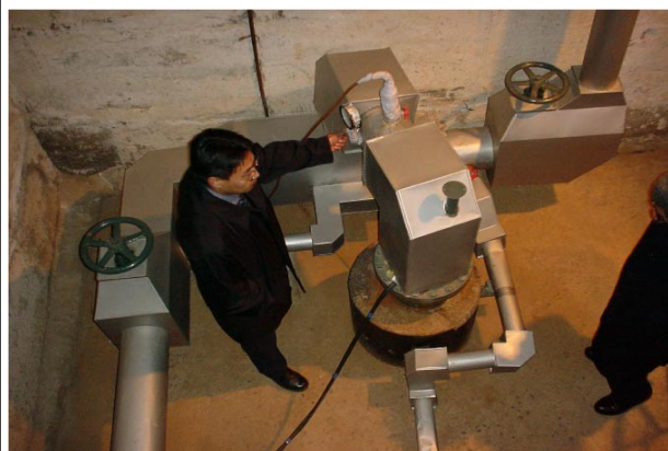
保温設備の整った水源井内部(ウランバートル中央) (無償資金協力で事業化)
