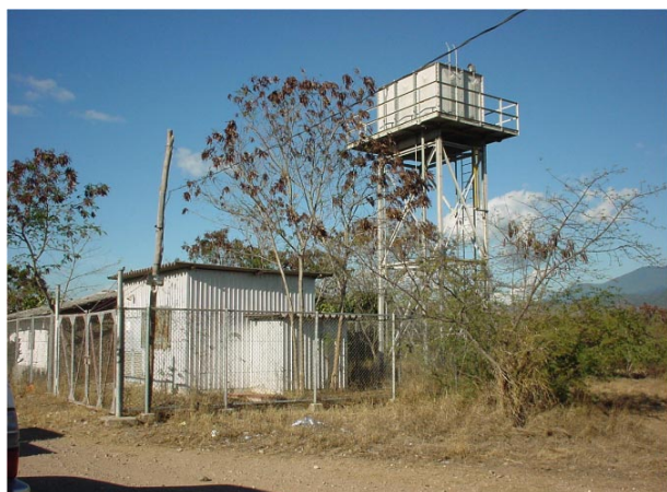
動力ポンプ付深井戸給水施設と高架水槽 無償資金協力で事業化
