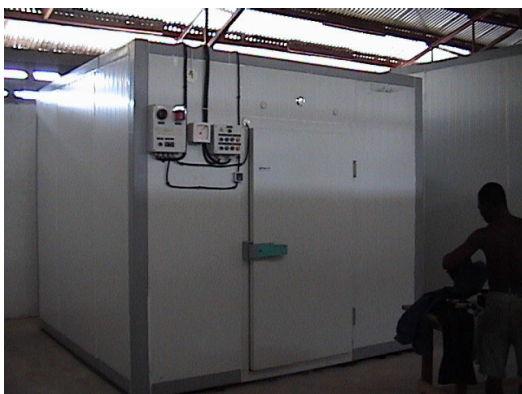
新設冷凍庫 (ユニセフ)
