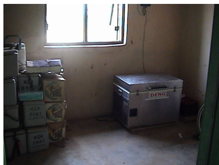
ソーラー電池式冷蔵庫
