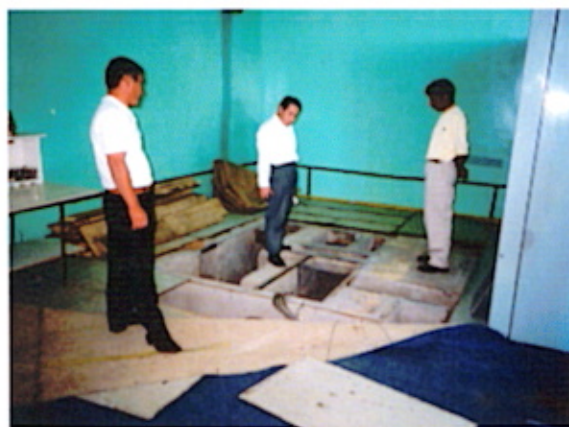
アルタイ送信所 新設 10kW 短波送信機の設置予定場所
