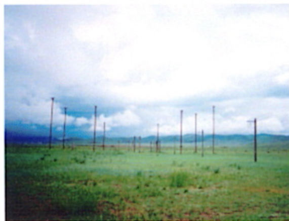
ムルン送信所 既存短波アンテナ。本プロジェクトの実施に伴い撤去される。
