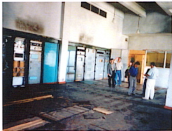
ウランバートル送信所 局舎2階 50kW 短波送信機の設置予定場所
