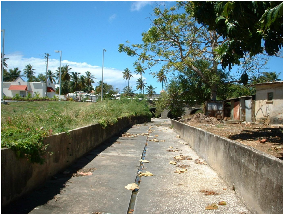
モデルプロジェクト実施予定地・バルバドスのスパイツタウン( 2002 年 2 月 27 日撮影 ): 川の右側の土地が低く、幹線道路の土堤( 前方 )の影響もあって雨季には毎年冠水する。
