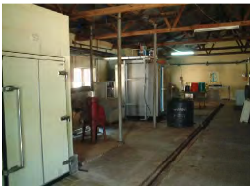
■ニゲジ内水面漁業訓練学校内の冷凍施設。
