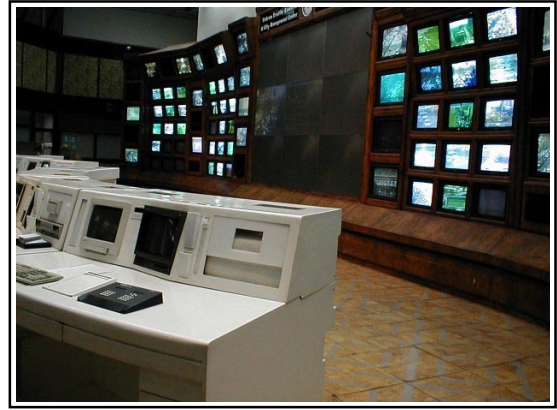
TTCC の交通監視センター
