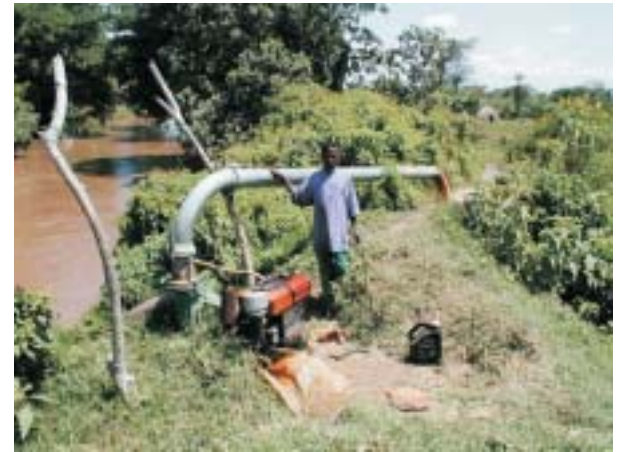
民間業者が設置した小型ポンプ
