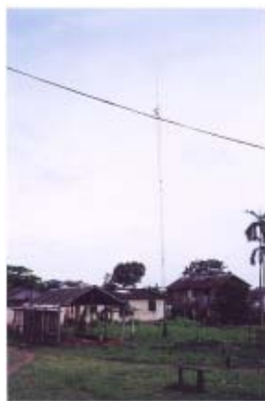
ラジオ無線施設
