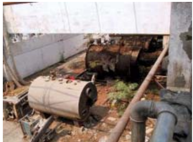
ボイラー室：老朽化し放置された設備機器
