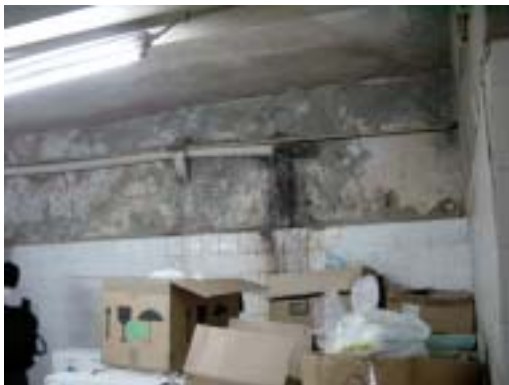
地下倉庫：換気設備がなく外壁からも漏水
