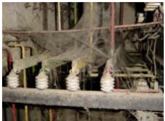
電気室：H棟電気室の現状
