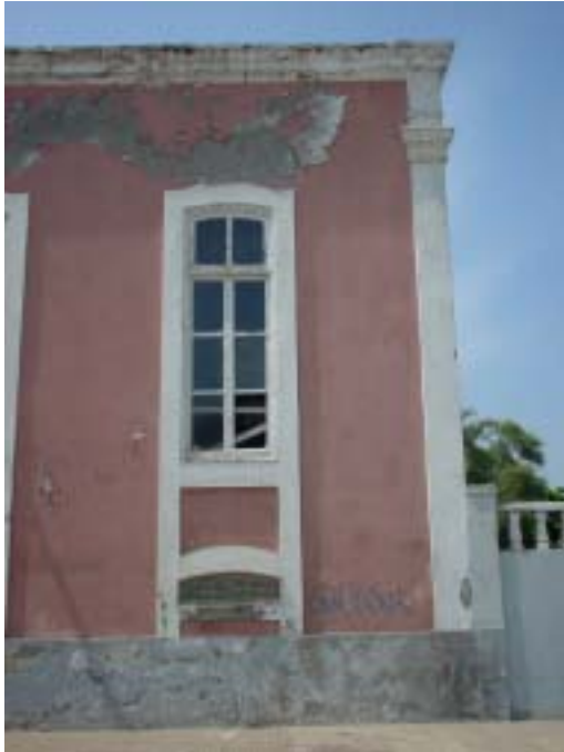
正面外壁：外装のクラック、塗装の剥離
