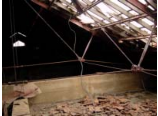
屋根：ロケット弾による破損状態
