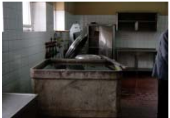
キッチン：給水システム不良のための貯水槽
