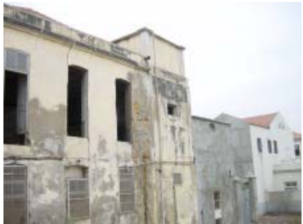
E病棟外壁：屋根の破損により使用老朽化が著しい
