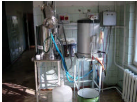
G02 蒸留水製造装置
