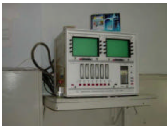
C05 セントラルモニター（ICU）
