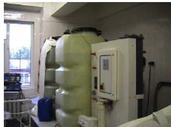
H02 水処理装置
