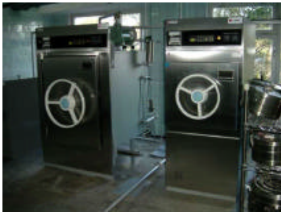
G01 アクサイ小児病院 高圧蒸気滅菌装置
