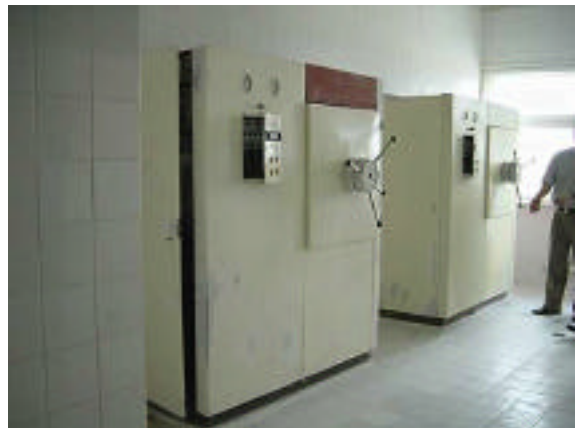
B12 高压蒸気滅菌装置 (中央滅菌室)
