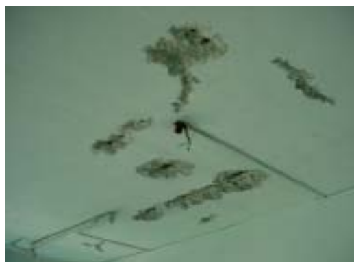
天井コンクリート剥離箇所
