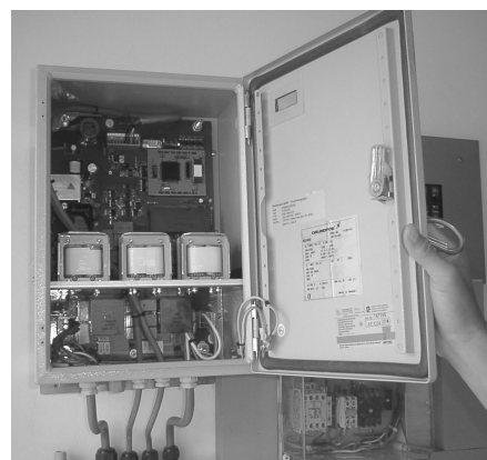
ソーラー発電システムのインバーター
